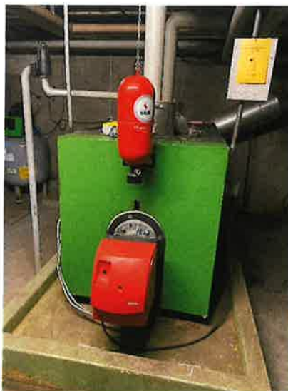
Figure 3 : chaudière et brûleur
